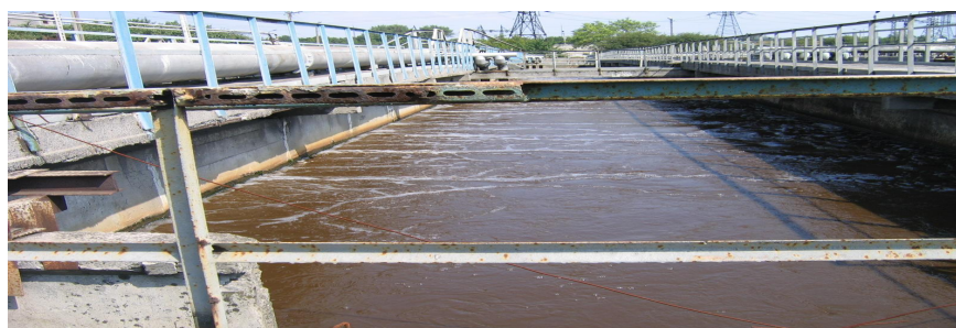
Рис. 1. Аеротенк очисних споруд м. Дніпродзержинськ
